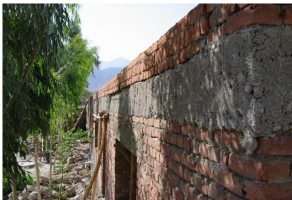
کانکریټ د گاډر په قالب کېني ډیر ضعیف جوړ شوي او ددې باعث ګرځي چې خالي ځایونه یې نم ووهي.
