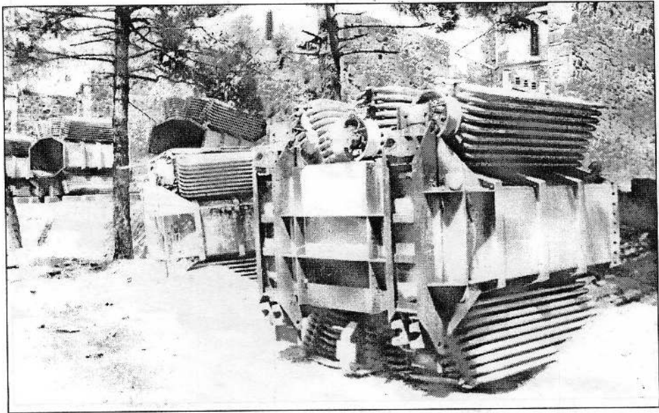
ساحات تخریب شده ترانسفرمری برشنا کوت دهه ۱۳۷۰
