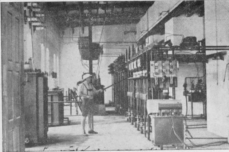
اطاق ترانسفارمهای فابریکه برق جبل السراج
