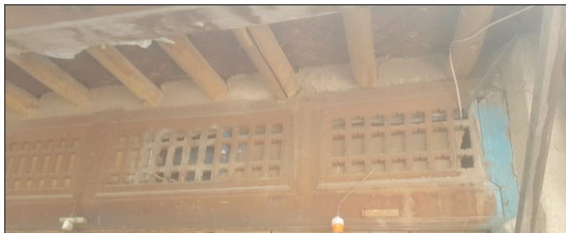
عکس از سقف پیک اتاق بدون مسطح
