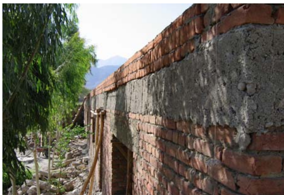
کانکریټ د گاډر په قالب کېني ډیر ضعیف جوړ شوي او ددې باعث ګرځي چې خالي ځایونه یې نم ووهي.
