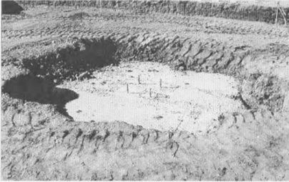
8.3 شکل. یو مکمل ځانگړی تهدا ب چې څلور بولټونه د اوسپنیز پایې د قاعدې د پلیټ سره د اتصال ورکولو په منظور پریښودل شوي دي (142:19).
