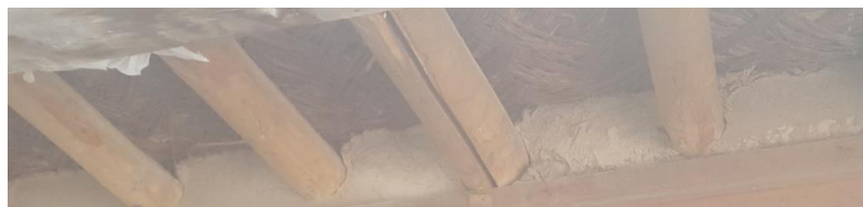
عکس از سقف پیک اتاق بدون مسطح
