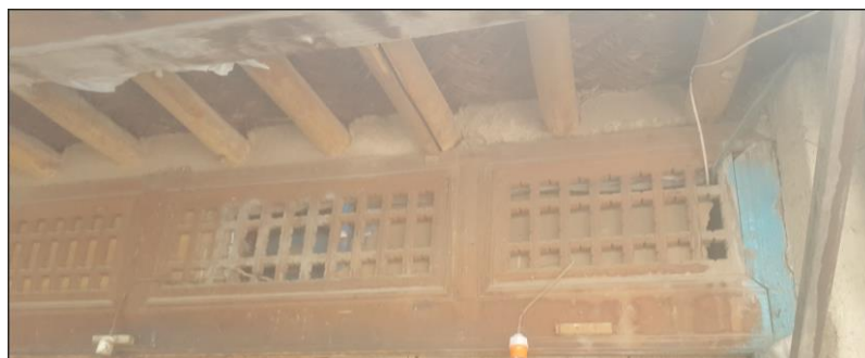
عکس از سقف پیک اتاق بدون مسطح
